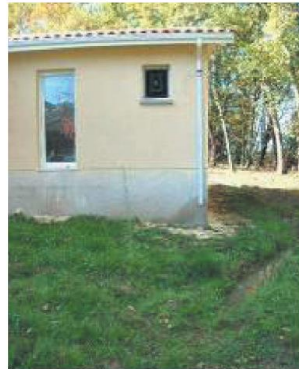
Figure 11 La descente d'eaux pluviales non raccordée concentre l'hydratation accidentelle dans l'angle. Les eaux ne sont pas évacuées du fait de l'absence d'un nivellement adapté et stagnent non loin de l'angle (Source Socabat)
