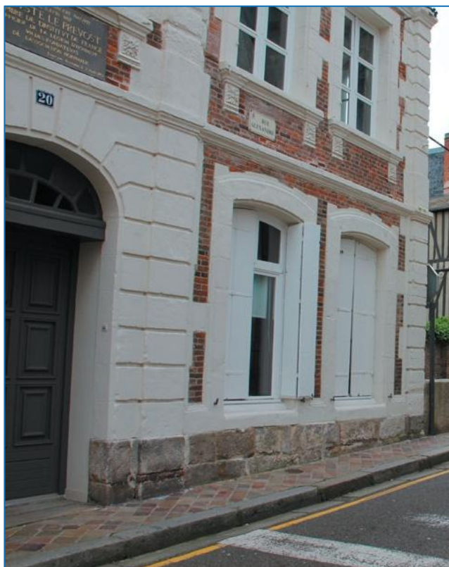
Les éléments en pierre ont été recouverts de peinture blanche, ce qui appauvrit le jeu d'ombres des moulures et entraîne la dégradation de la pierre
