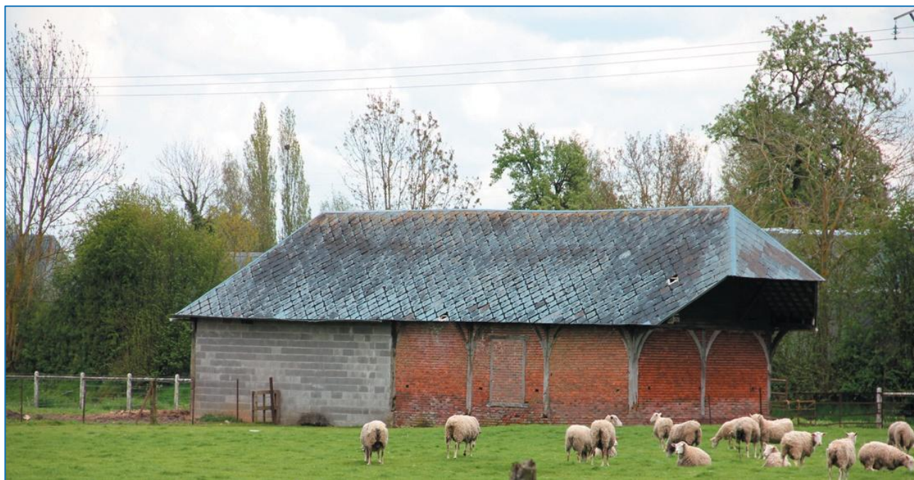
Hameau Le Malharquier - couverture en fibrociment losangé de qualité médiocre
