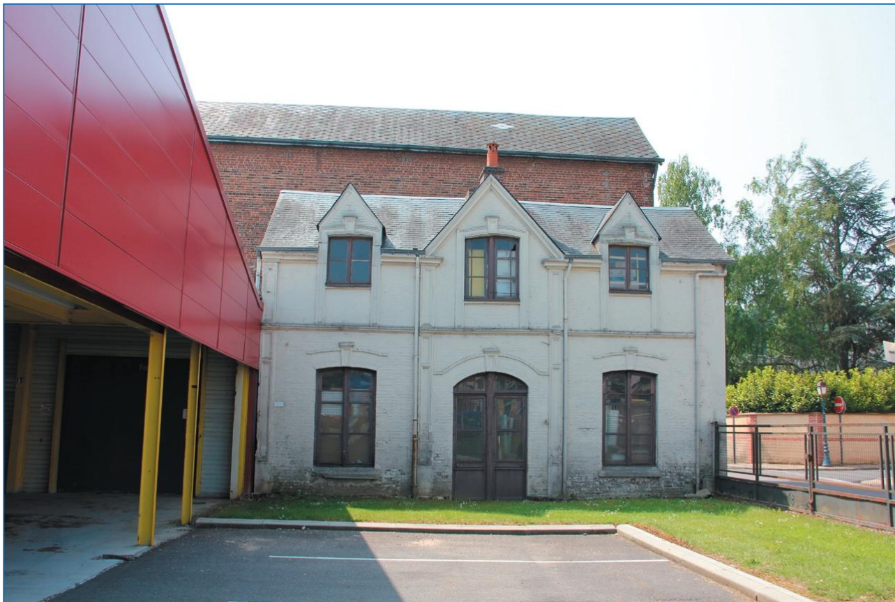
Maison annexe de l'usine Galant, rue Gombert - brique et pierre dégradées par la couche de peinture
