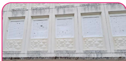
Volets roulants de l'école du Bourg-Le-Comte détériorés par l'orage de grêle du mois de juin 2025
