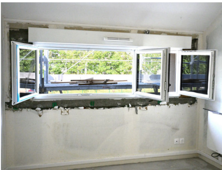
Pour améliorer le confort thermique et la sécurité des résidents, les fenêtres ont été remplacées par des modèles oscillo-battants avec l'installation de volets roulants.
